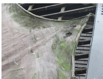
Groenaanslag en scheuren in het zeil
