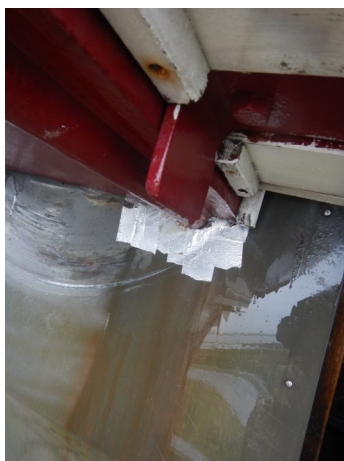
Beschadiging maneberd door schuren van de askop
