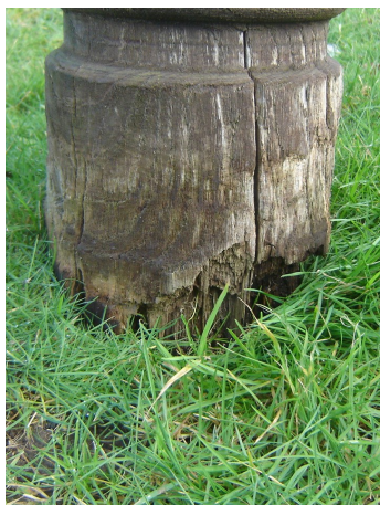
Kruipaal onderaan vertoont sterke verweringsporen.
