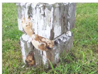
Sterke inrottingen door achterstallig schilderwerk.
