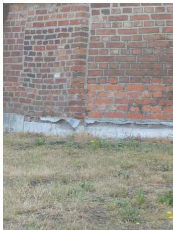
Schade door onzorgvuldig maaien.
