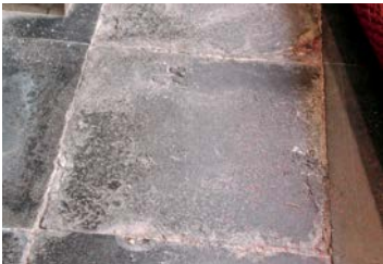
② Afschilferende vloer
