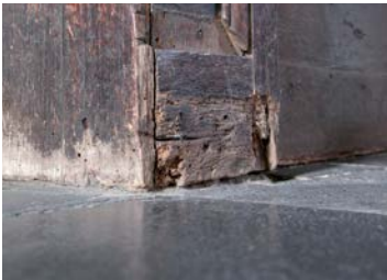
③ Schade aan houten elementen door nat reinigen
