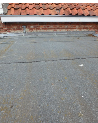
Oneffenheden van de dakbedekking
