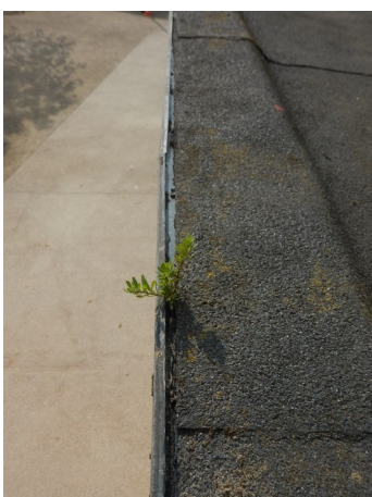
Onvoldoende hoogte en verkeerde afwerking van de dakranden.
