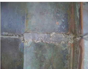
Gecorrodeerde soldeernaad door gebruik van een verkeerd type soldeer.
