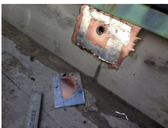
Een perforatie in de goetopstand wordt duurzaam hersteld met een nieuw te solderen koperen plaatje. Het te solderen oppervlak in de goetopstand wordt blank geschuurd en zowel het nieuwe koperen plaatje als de goetopstand worden voorvertind.
