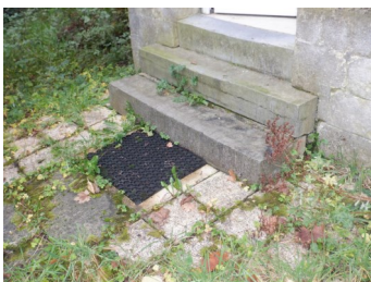
Plantengroei in een halfopen verharding uit betontegels in de uitgespoelde zandvoegen.
